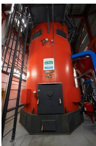
トマーチン社のバイオマスボイラー
